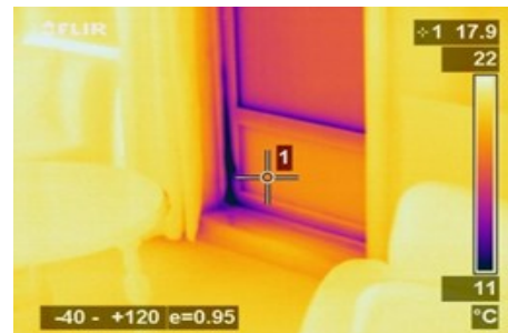
Värmefotografering är ett sätt att hitta energitjuvar i form av läckage
