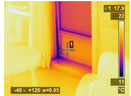
Värmefotografering för att hitta läckage
